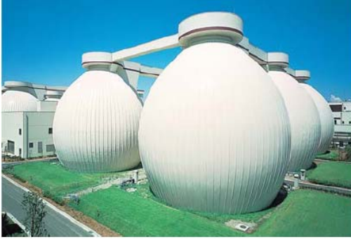
รูป 8.2.2 ตัวอย่างถังหมักการย่อยตะกอนสลัดจ์แบบไม่ใช้ออกซิเจนขนาดใหญ่ (Northern second sewage treatment plant)
