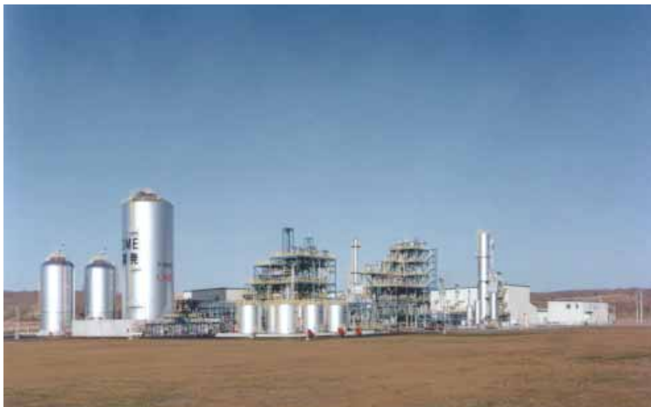
DMEパイロットプラント(提供:JFEエンジニアリング)
